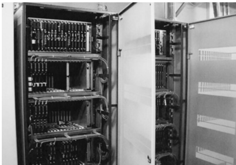
更新予定の庁舎電話交換機
