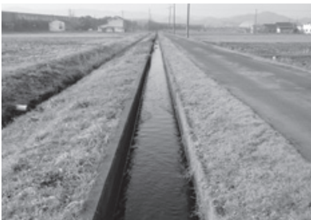
経年変化で損傷などが進む農業施設
