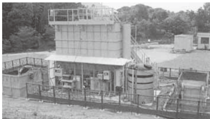
▶工業団地1号調整 池の濁水処理機
