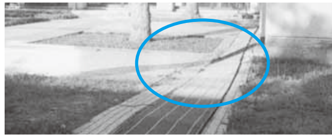
▲地盤沈下する西小学校の中庭
