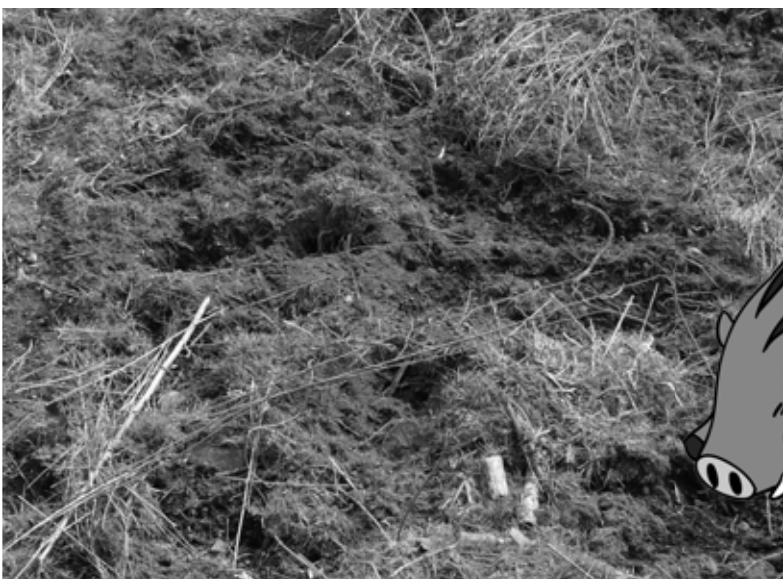
イノシシに荒らされた穴だらけの堤防
