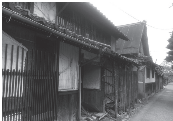
整備が必要な空き家
