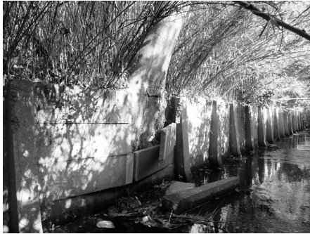
立木による護岸欠損
