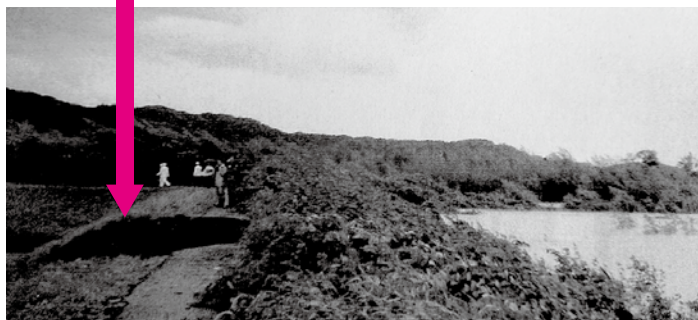
平成25年9月の台風による破堤寸前の日野川堤防
