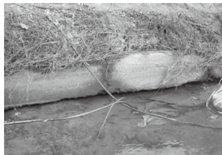
河床に隙間ができた基礎部分
