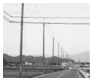
道路肩を占用する電柱
