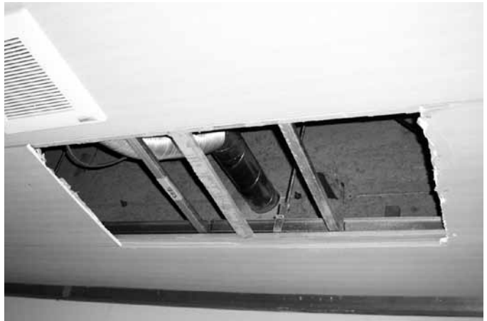
竜王幼稚園 天井の雨漏れ箇所
