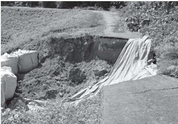
決壊寸前の日野川堤防
