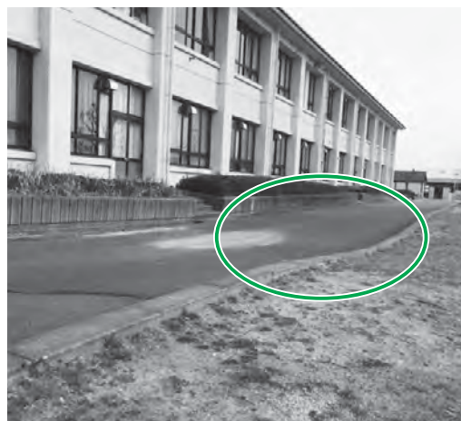
地盤沈下が生じている通路
