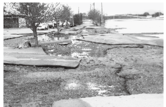
新川決壊により道路・駐車場のアスファルトがはがれる
