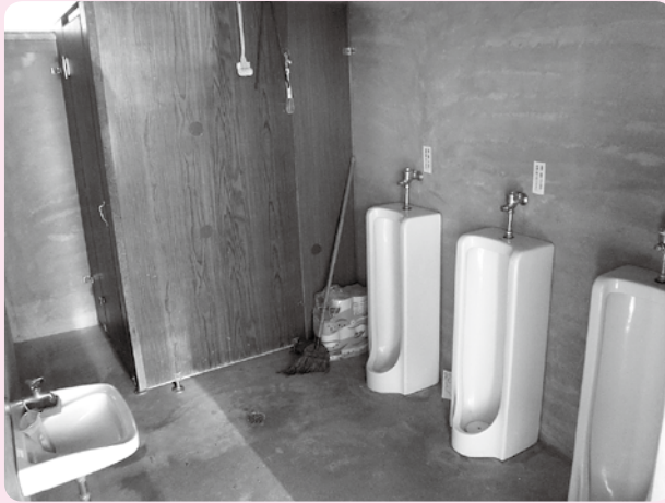
改修予定のトイレ
