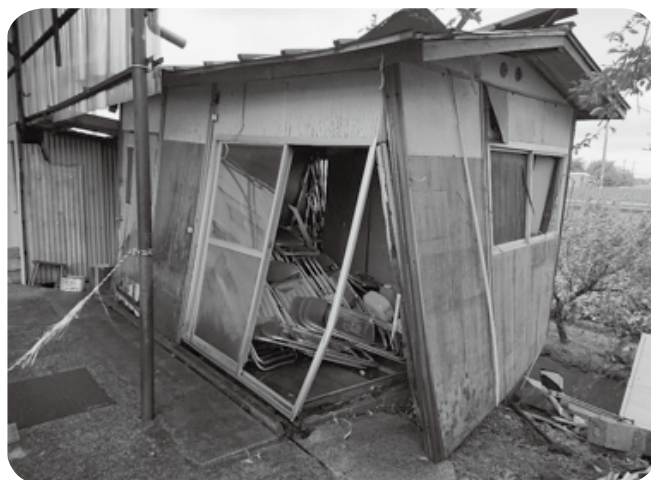
台風被害により撤去された物置(竜王小学校)
