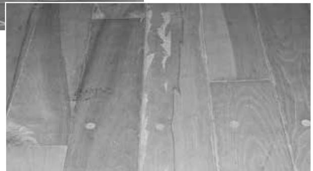
修繕が必要な西小学校体育館の床
