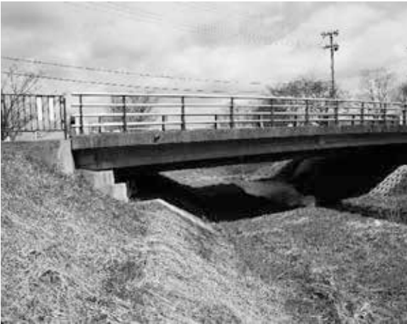
補強が望まれる山田川橋（山面地先）
