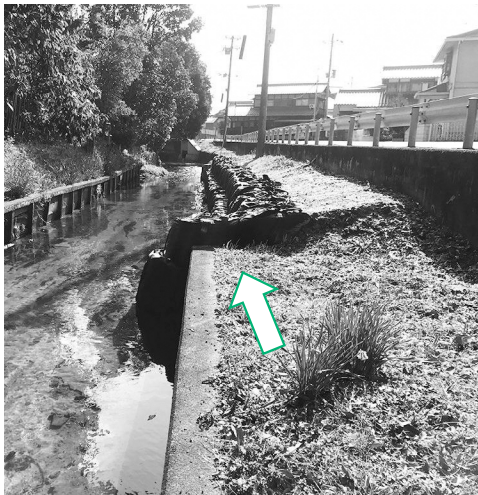
浸食され土のうが積まれた大洞川
