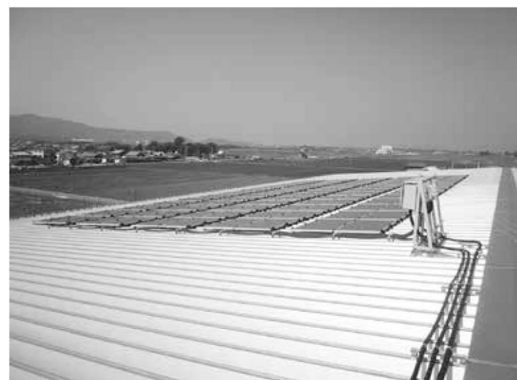
竜王中学校体育館の太陽光パネル
