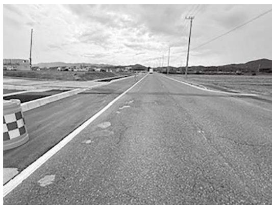
町道東西線の路面に轍やひび割れが発生
